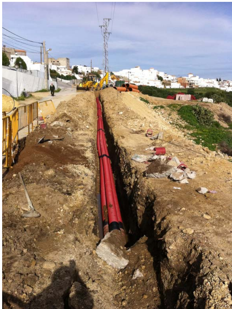
FOTO 2.- vista de la fase anterior en donde se construye la canalización de la red eléctrica prevista.
