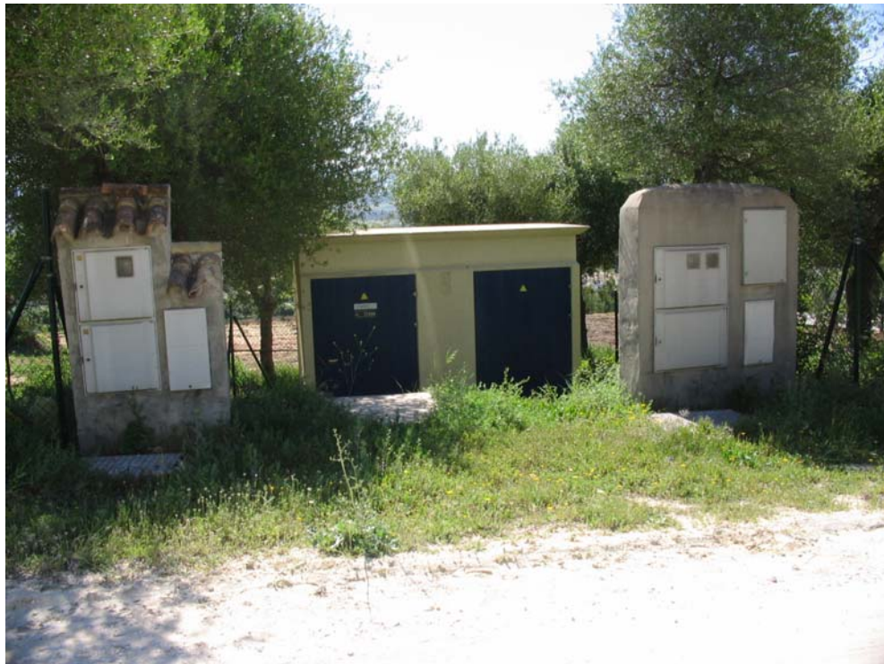
FOTO 4.- vista de centro de transformación y cuadros eléctricos.
